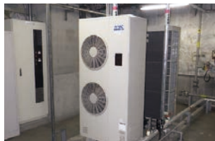
横浜コンピュータセンター
