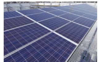
横浜コンピュータセンター(北館屋上)
