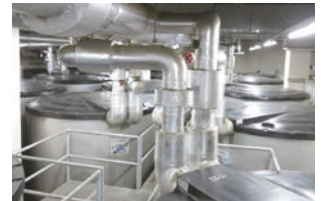
横浜コンピュータセンター
