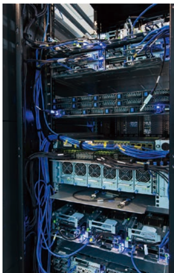
OCP仕様のサーバ
