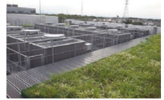
横浜コンピュータセンター(北館屋上)
