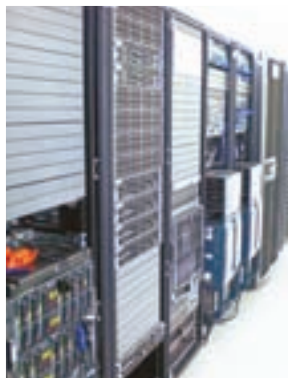
金融HPCラボ内の様子
