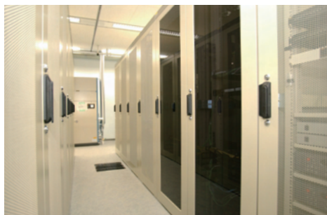
●堅牢な設備を誇るデータセンター
